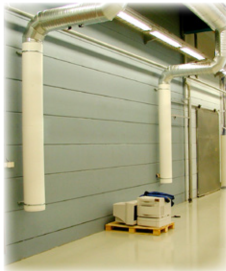
Tilluftsdon S11. Vertikalt monterade i en verkstadshall.
