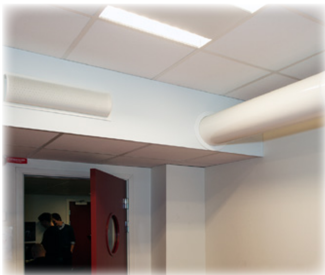
Tilluftsdon S 55 (vänster) samt S11 (höger) monterade i en skolsal.
