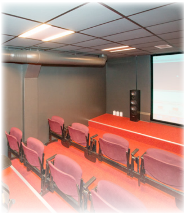
Ventilation till föreläsningsslokaler.
