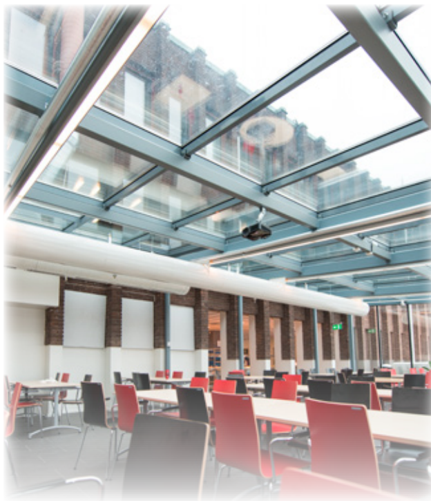
Ventilation till samlingslokaler.
